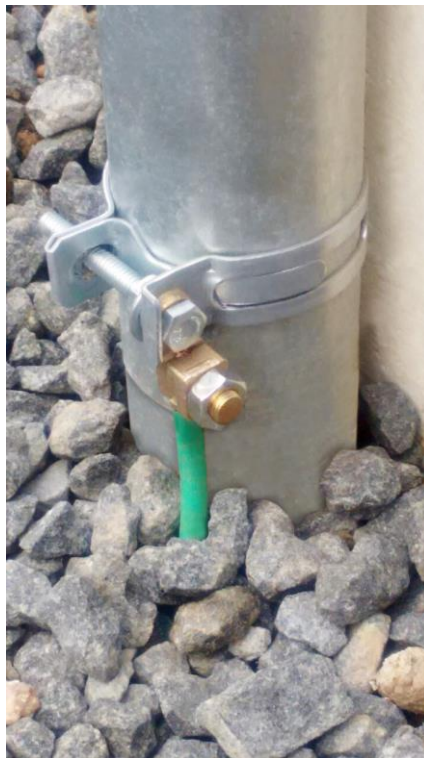
Foto ilustrativa 02 dos anexos G, H e Q – Detalhe da abraçadeira com terminal para aterramento
